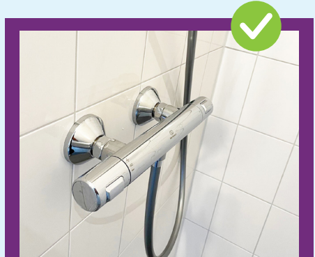
Kranen | douchekop zijn ontkalkt
